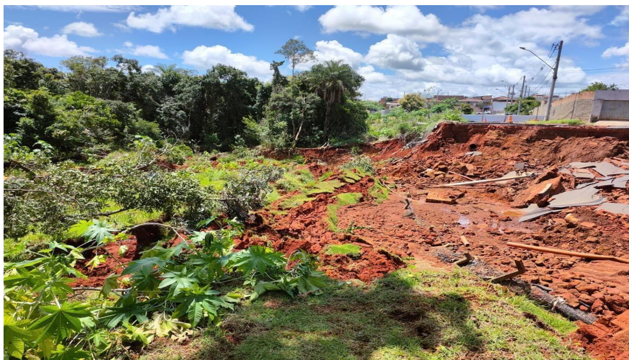
Figura 1-6 – Segunda erosão, ocorrida em janeiro de 2023 (Fonte: Consórcio Minas Projetos, 2023)
