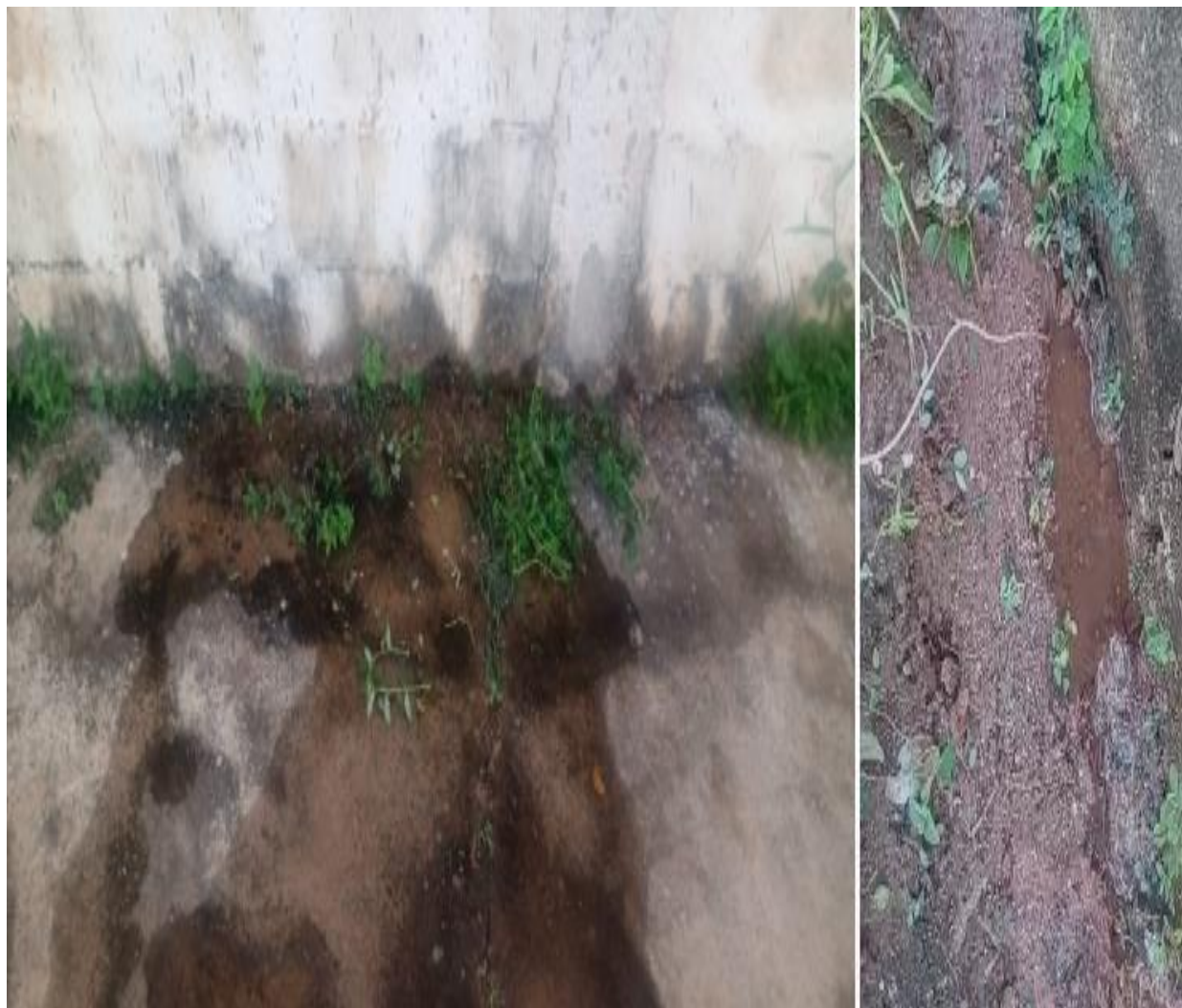
Figura 1-4 - Afloramento do lençol na base do muro de uma residência da Rua Wagner Fugêncio, registrado em julho de 2022. (Fonte: https://www.portalmibiara.com.br/noticia/categoria/1/cidade/link/12049/local-da-erosao-no-pao-de-acucar-iii-em-araxa-ja-apresentava-problemas-deste-2019#:~:text=Em%20dezembro%20de%202019%2C%20com,d,e%20R%24%20312.186%2C68. )
