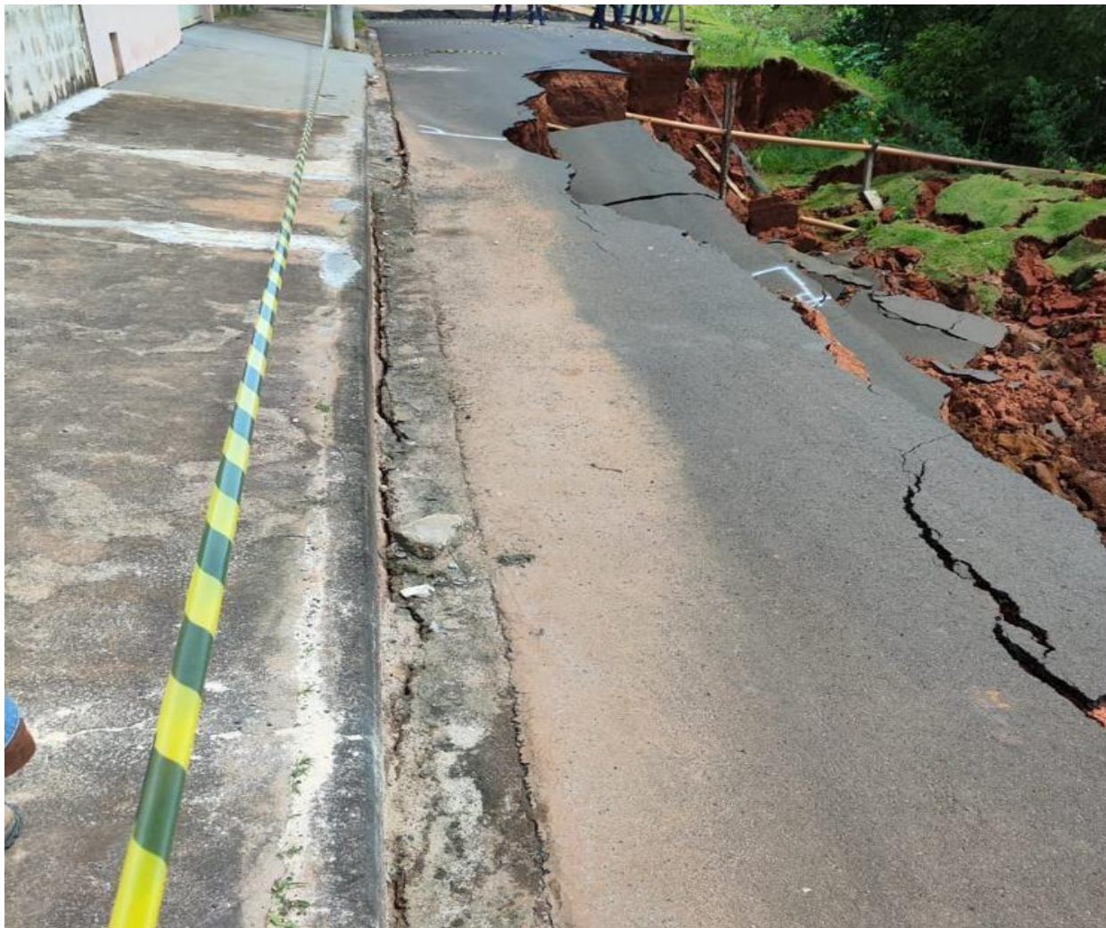
Figura 1-7 – Situação do pavimento da Rua Wagner Fugêncio após deslizamento da pista
