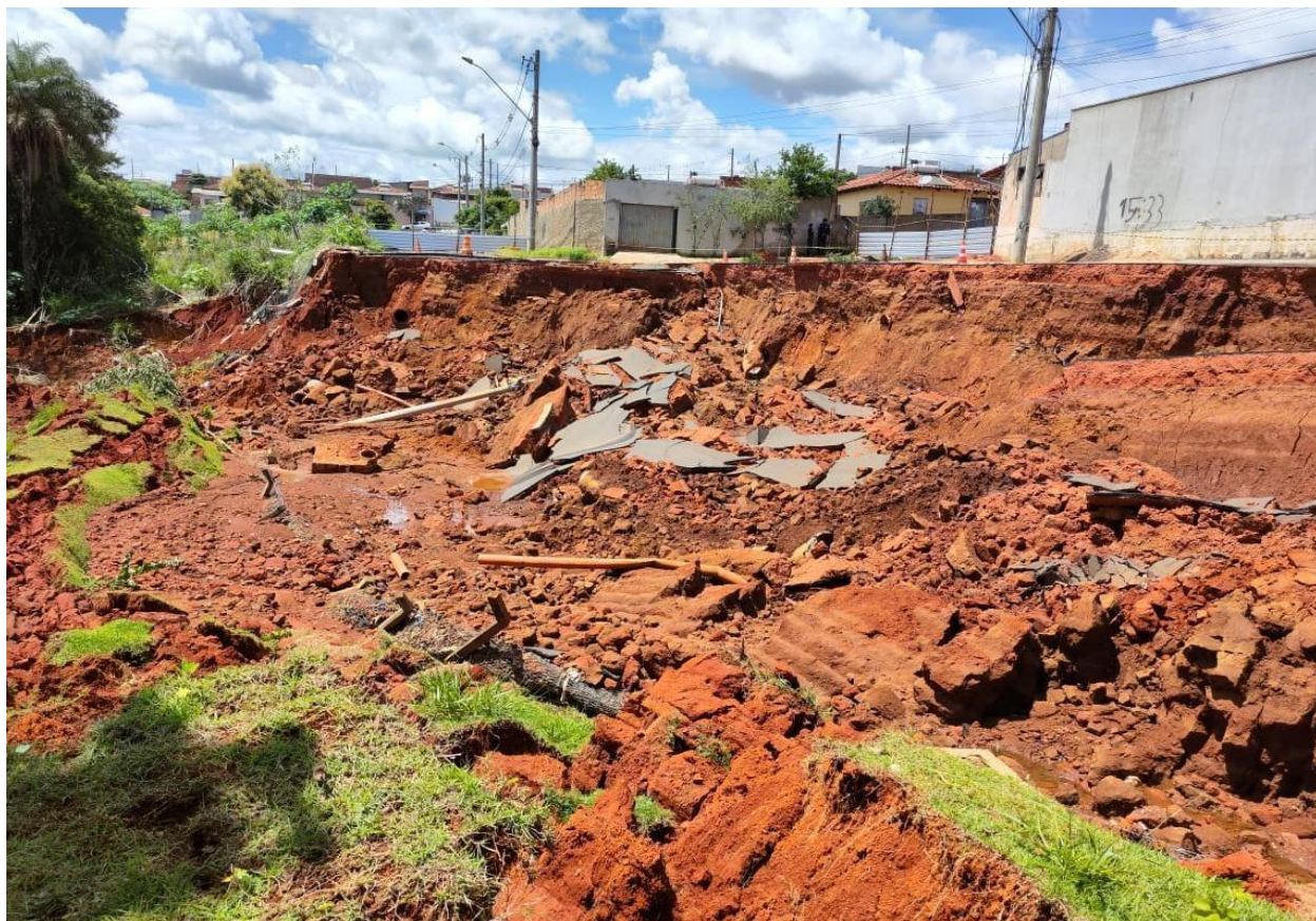
Figura 1-5 - Segunda Erosão, ocorrida em janeiro de 2023 (Fonte: Consórcio Minas Projetos, 2023)
